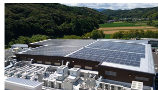
太陽光発電施設
